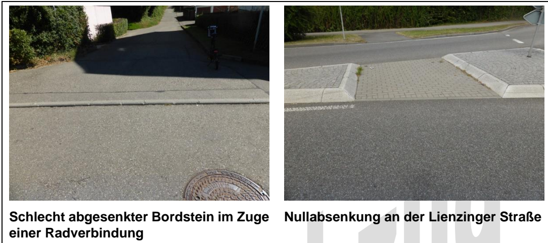
Abbildung 21: Unterschiedlich gut abgesenkte Bordsteine in Mühlacker (Fotos: R+T)
